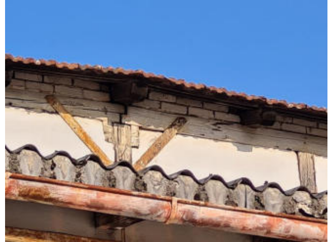
Foto 32: Oberer spaltiger Traufbereich im Osten des Gebäudes (G) der Fa. Starke (30.6.22).
