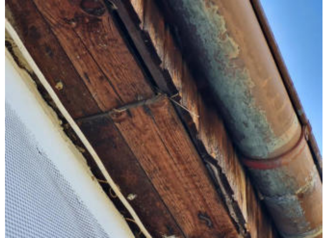
Foto 50: Spalten im Traufbereich von Gebäude C (30.6.22).
