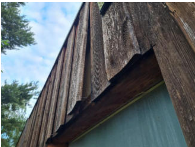
Foto 11: Abstehende Bretter an der Südfassade des Gebäudes A (30.6.22)
