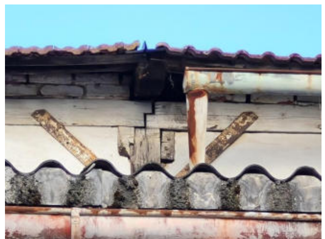
Foto 30: Oberer spaltiger Traufbereich im Osten des Gebäudes (G) der Fa. Starke (30.6.22).
