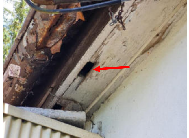
Foto 62: Traufbereich mit Loch im Süden von Gebäude D (30.6.22).
