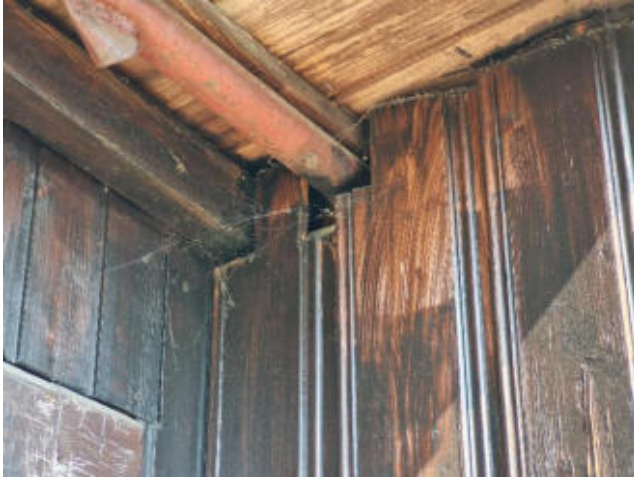
Foto 49: Spalten im Traufbereich von Gebäude C (30.6.22).
