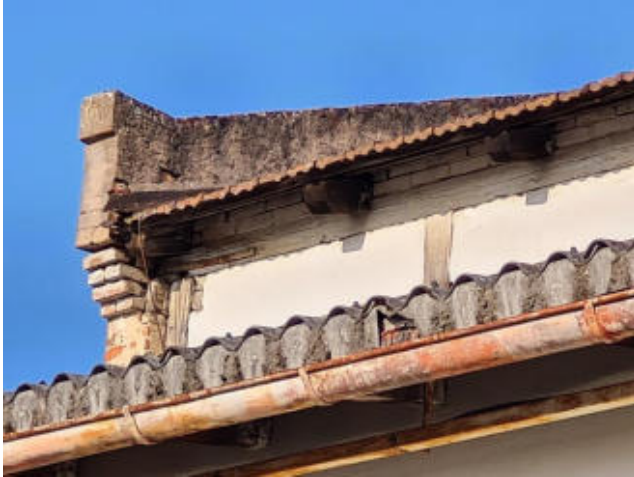
Foto 31: Oberer spaltiger Traufbereich im Südosten des Gebäudes (G) der Fa. Starke (30.6.22).
