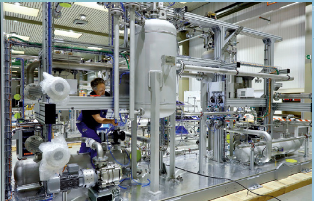
Siemens Energy arbeitet an der Zukunftstechnologie: Prozess- und Versorgungstechnik für den Elektrolyseur.
