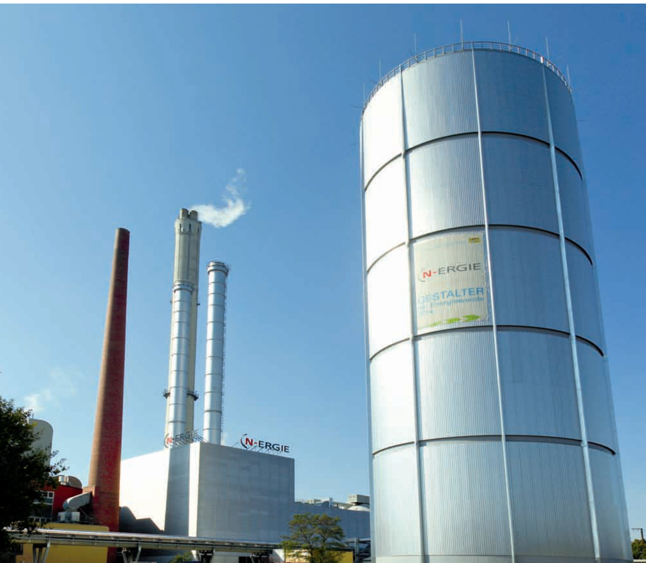
Der Speicher der N-Ergie neben dem Heizkraftwerk in Sandreuth gleicht Schwankungen bei der Wind- und Sonnenenergie aus.
